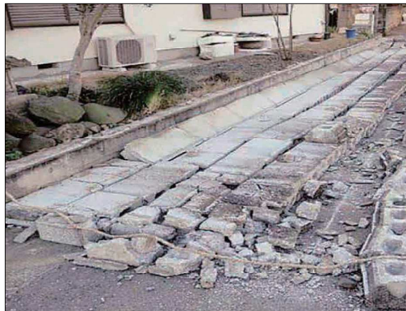
ブロック塀倒壊の様子
