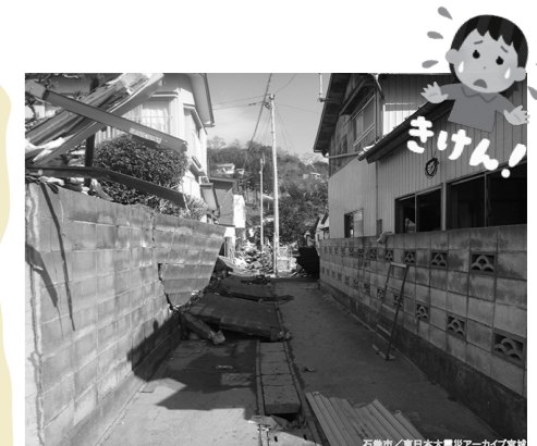
▲倒壊すると非常に危険です。 出典:東日本大震災アーカイブ宮城(石巻市)
