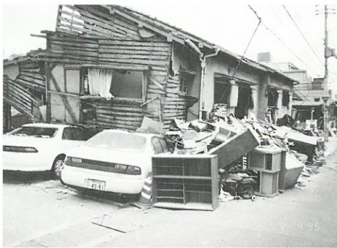
1階の壁量が少なく、地震で倒壊した住宅（阪神・淡路大震災）
