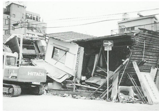
倒壊した木造住宅
