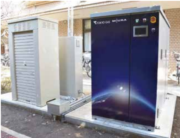
設置された超高効率燃料電池システム
