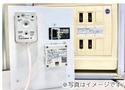
一定の揺れを感知すると自動的に電気を遮断し、地震による電気火災を防ぎます
