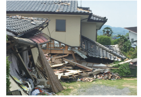
熊本地震による被害の様子
