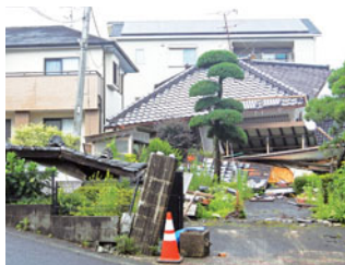
熊本地震による被害の様子
