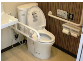
車いすトイレの例
