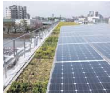
谷原小に設置した太陽光発電設備
