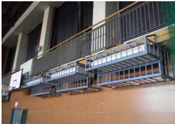
▲体育館の空調設備
