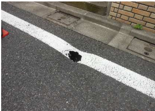
道路陥没状況
