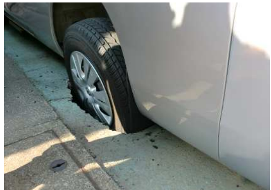
道路陥没による事故状況
