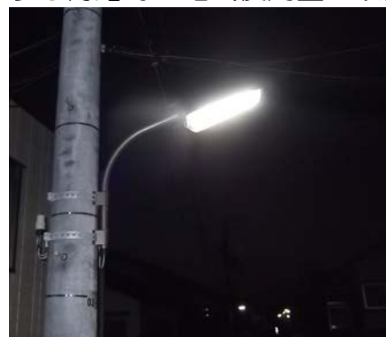
（省エネルギー型街路灯）
