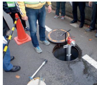
▲訓練の際に消火栓に差し込んだスタンドパイプ
