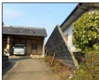
傾いたブロック塀 (平成 28 年熊本地震)
