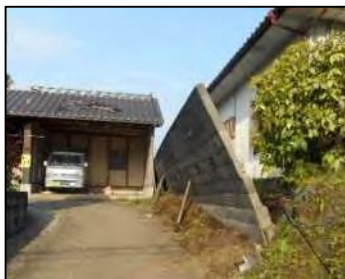
傾いたブロック塀 (平成28年熊本地震)
