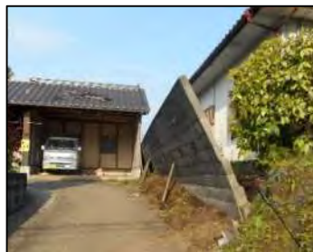
傾いたブロック塀 (平成 28 年熊本地震)
