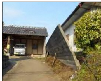
傾いたブロック塀 (平成 28 年熊本地震)
