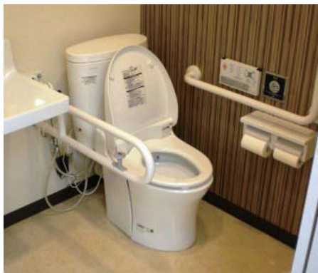
トイレの整備事例
