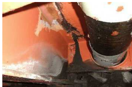
【主桁端部の腐食】
