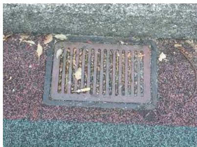
【排水ますの土砂詰まり】
