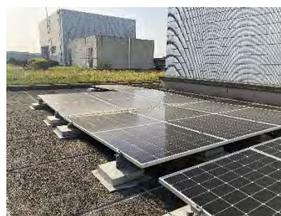
太陽光発電設備（光が丘区民センター）
