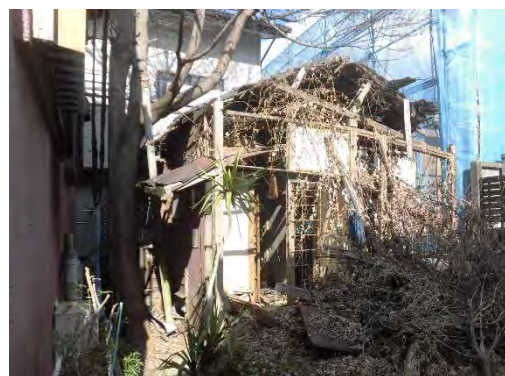
適正に管理されていない空き家
