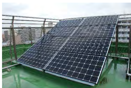
太陽光パネル
