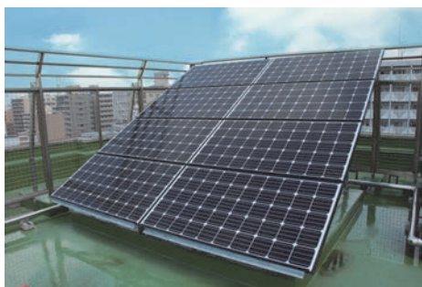
太陽光パネル
