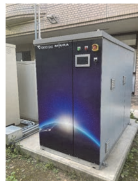
田柄特別養護老人ホームに設置した 超高効率燃料電池システム
