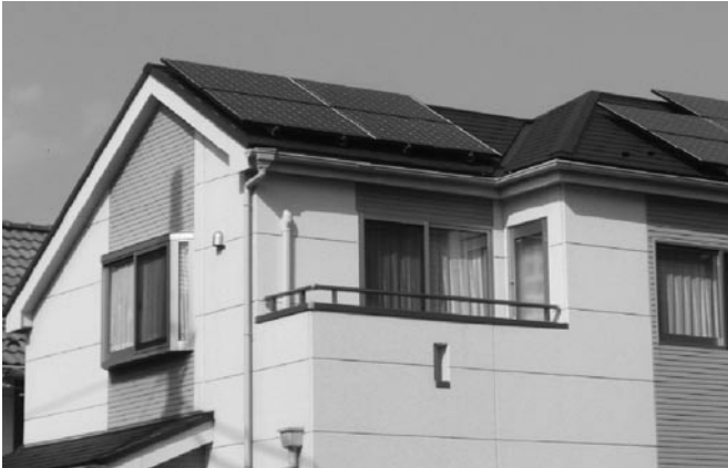
写真1 太陽光発電設備の例
