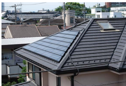
太陽光発電設備
