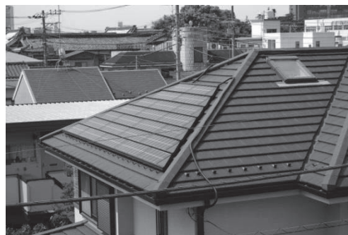
太陽光発電設備
