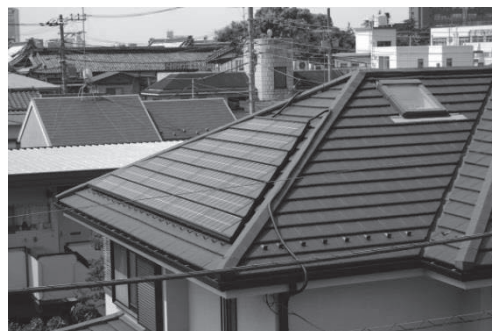
太陽光発電設備
