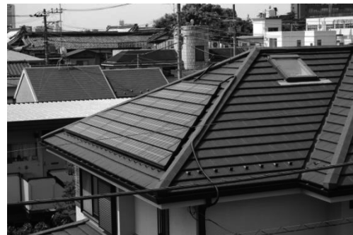
太陽光発電設備
