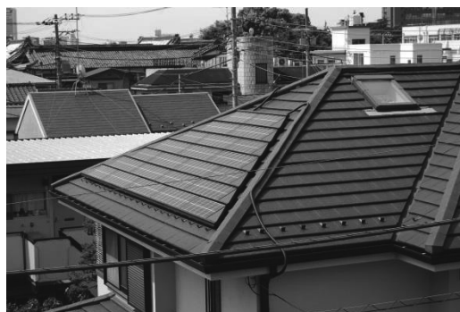
太陽光発電設備
