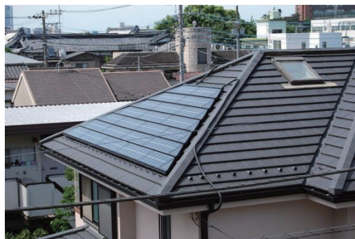
太陽光発電設備
