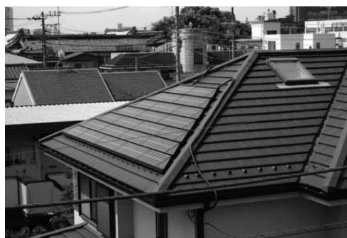
太陽光発電設備
