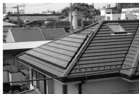
太陽光発電設備
