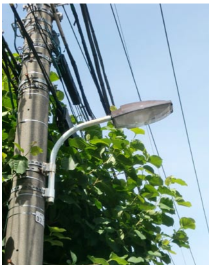
写真1 省エネルギー型街路灯
