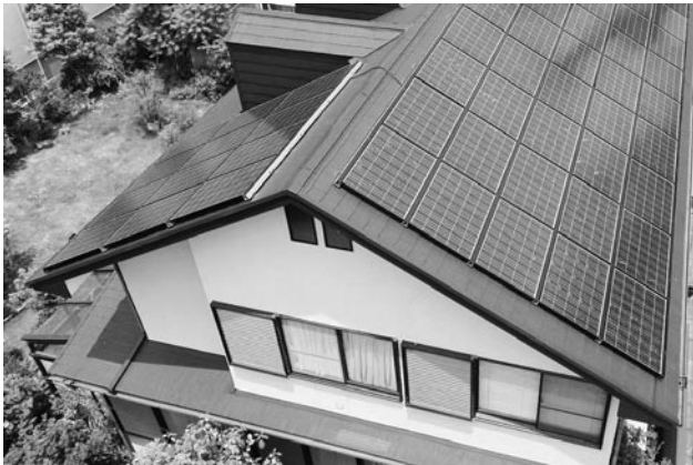
写真1 太陽光発電設備の例
