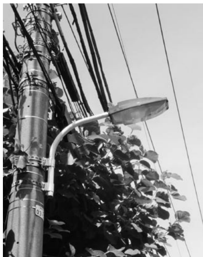
写真1 省エネルギー型街路灯
