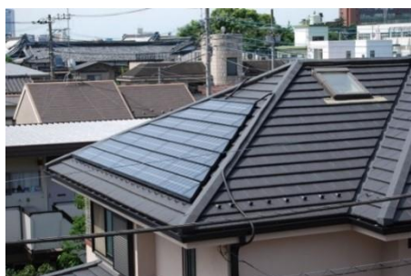
太陽光発電設備
