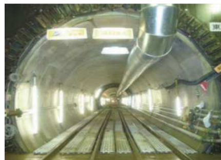
中村・豊玉北地区の雨水貯留管整備状況 （下水道） （写真出典：練馬区総合治水計画）
