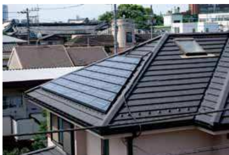
太陽光発電設備
