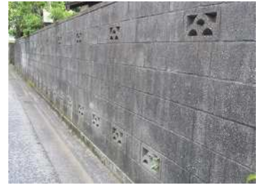
地区内に依然として 残るブロック塀
