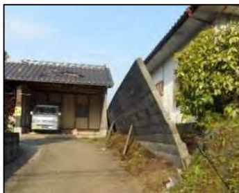
傾いたブロック塀 (平成28年熊本地震)
