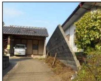
傾いたブロック塀 (平成28年熊本地震)
