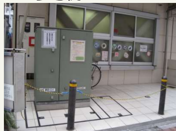
地上機器：公共施設への設置
