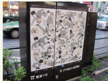
地上機器のラッピング
