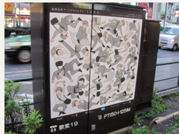
地上機器のラッピング
