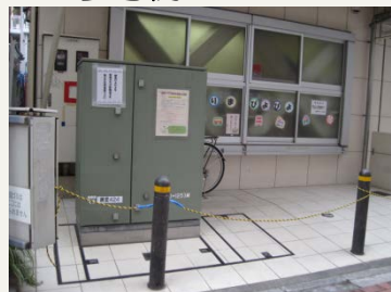
地上機器：公共施設への設置
