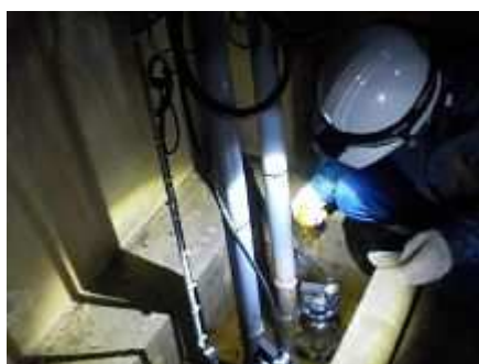
(3) - ⑤ ポンプの作動 (通常時の排水確認)
