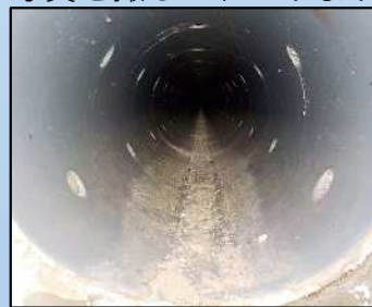
トレンチ管内部 写真を撮るとわかります
