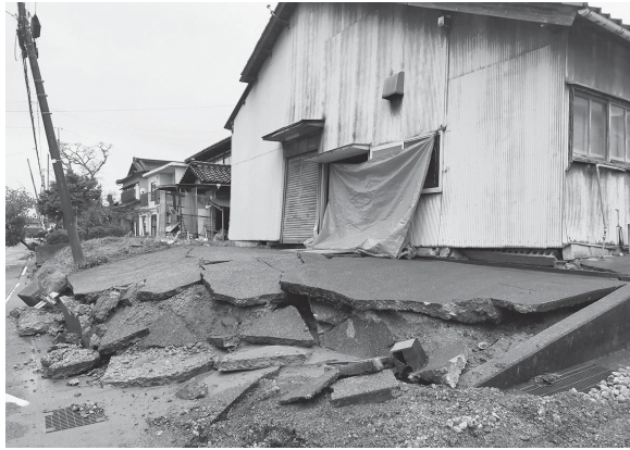
能登半島地震の被害の様子 (一財)消防防災科学センター
