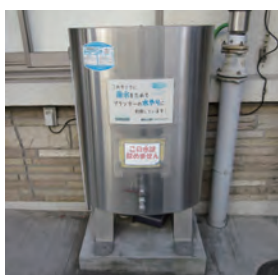
雨水貯留タンク（関町）
