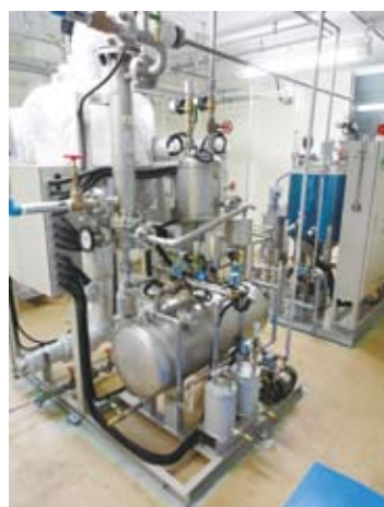
区が導入したバイオ燃料精製機
