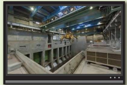
ごみクレーンでかき混ぜ、焼却炉に投入
