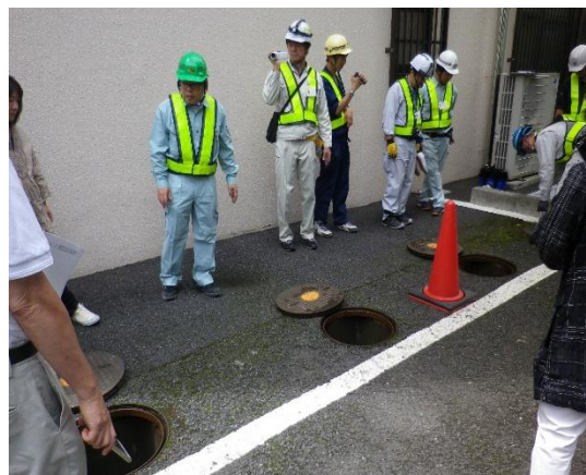
トイレからの排水管の破損状況点検
