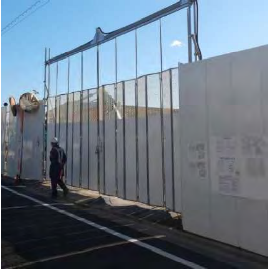
↑ 仮囲い(高さ3m)
