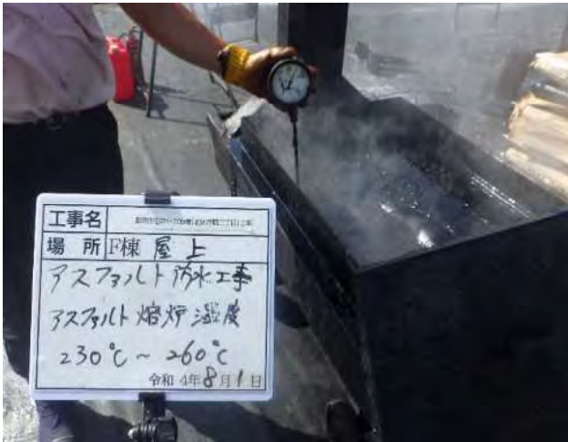
アスファルト溶炉
