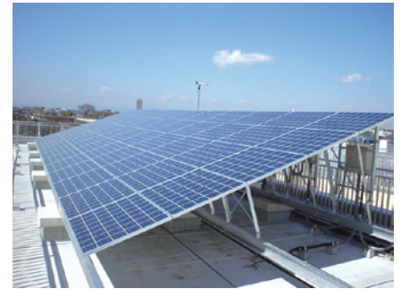
(参考) 光和小学校の太陽光発電設備
