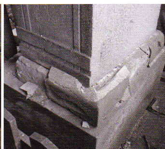
ひび割れた石宮の台座
